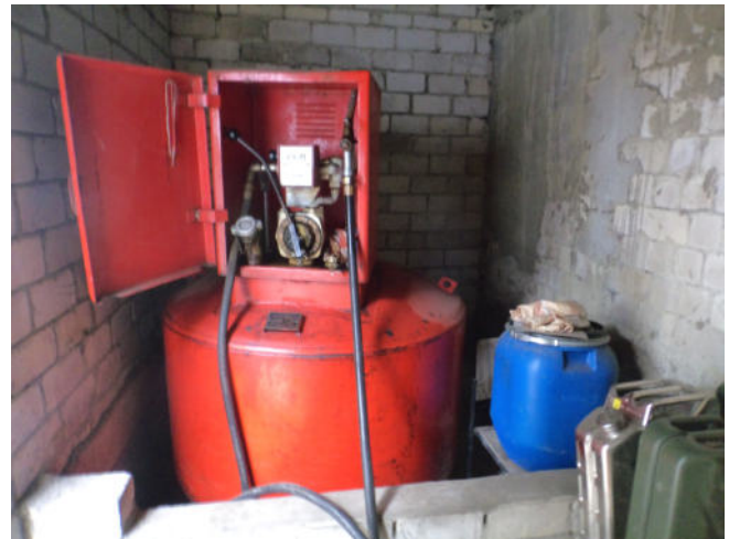
Foto 2: Dieseltank mit handbetriebener Pumpe in gemauerter Wanne im Tankraum
