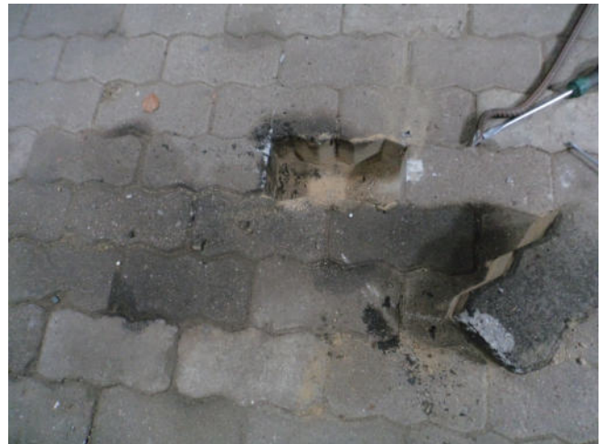
Foto 10: Betonpflaster im Bereich Ölfleck „Pelzhalle“, Öl nur oberflächlich, nicht bis in den Sand gelangt.
