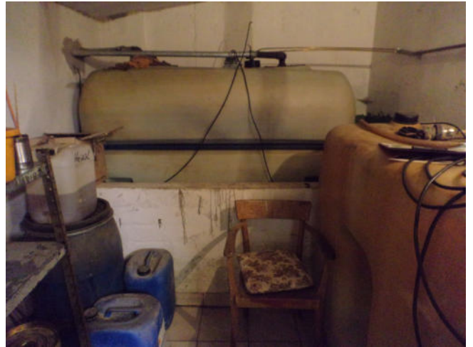
Foto 20: HEL-Tank in gemauerter Wanne im HEL-Lageraum, Tank rechts ohne Funktion (war mal kurzzeitiger Ersatztank)
