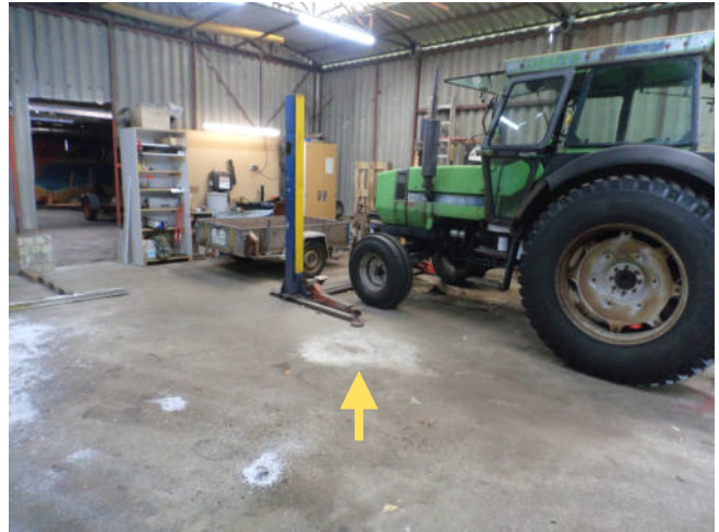
Foto 8: Windenhalle Bereich Hubbühne für gelegentliche Wartungsarbeiten der Flugplatz-Kfz, Schadstelle im Beton repariert. Gefälle des Bodens zur Schadstelle
