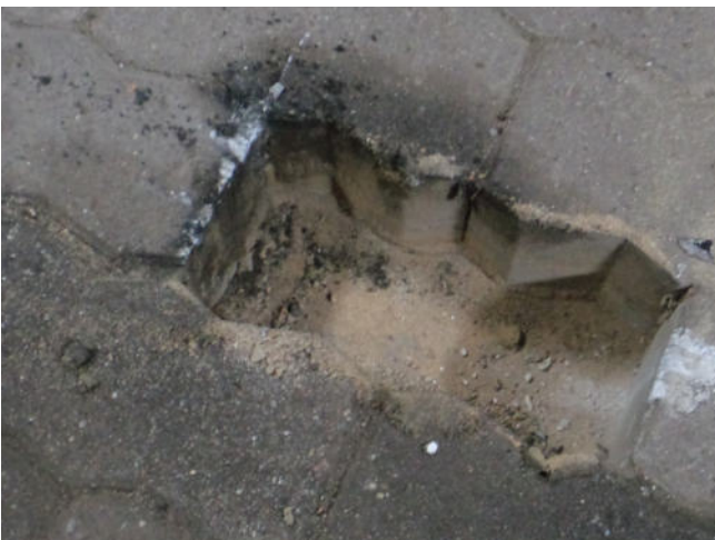
Foto 11: Detail Sand unter Betonstein
